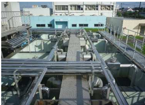
写真5 鶴ヶ島浄水場除鉄除マンガン装置
