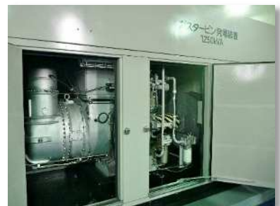
写真 9 非常用自家発電機
