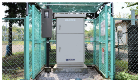
水質遠方監視装置
