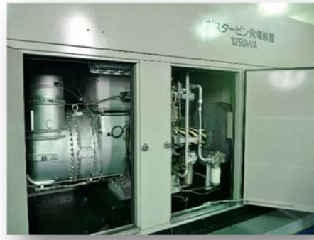
鶴ヶ島浄水場 非常用自家発電機
