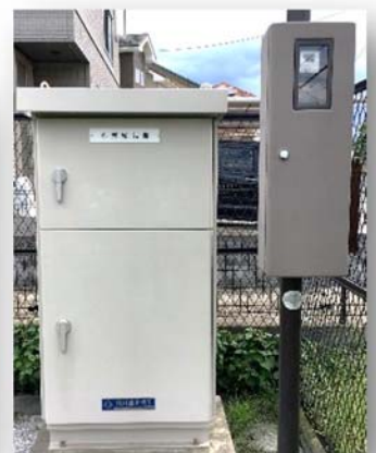
水質遠方監視装置
