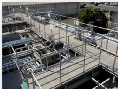
坂戸浄水場除鉄除マンガン装置
