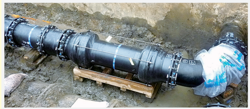
第1RC配水池伸縮可とう管*
