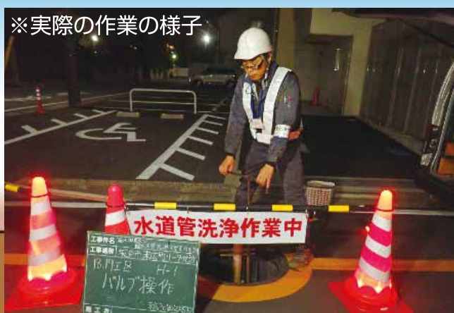
水道管（配水管）
