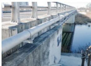
きょうりょうてんかかん 橋梁添架管
